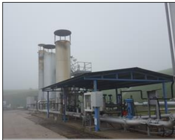
Figura 7: Gruppo torce per la decomposizione termica del biogas non inviato al motore (22.12.2015)
